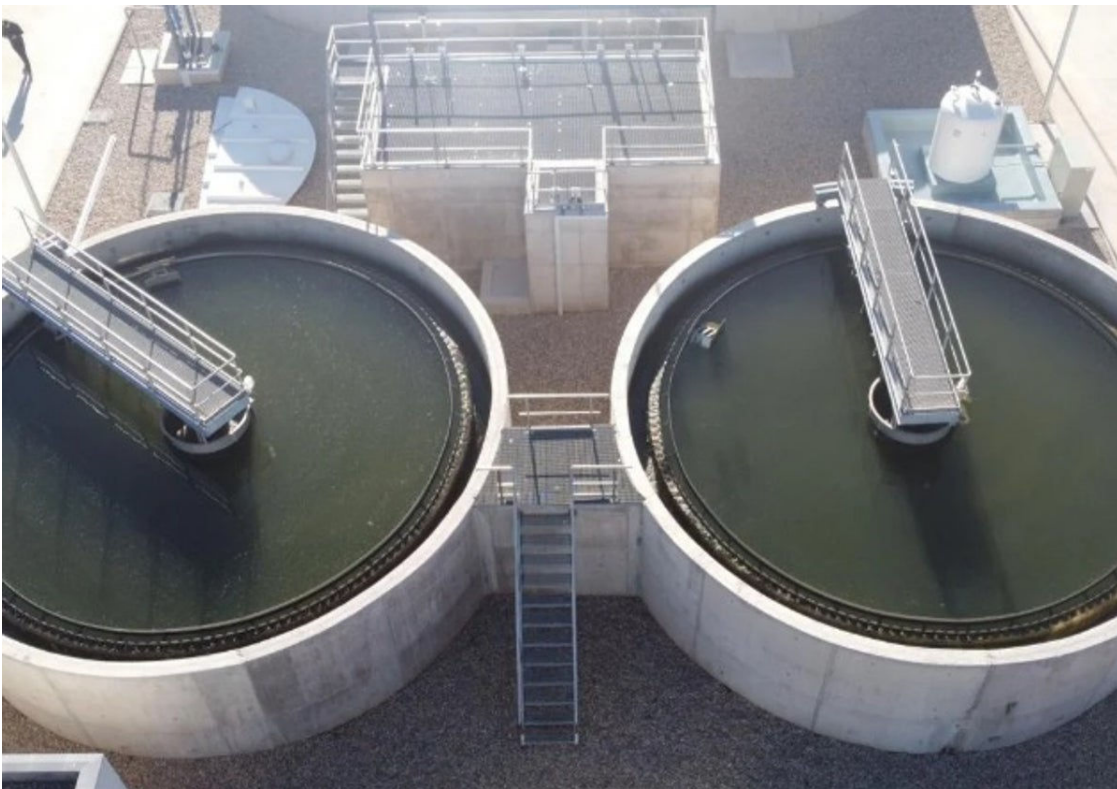
Vista de una estación depuradora ABC
